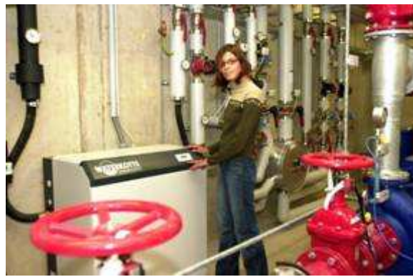
Wärmepumpe (Heizung und Warmwasser)
