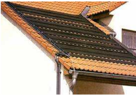
Solkollektoren auf einem Hausdach
